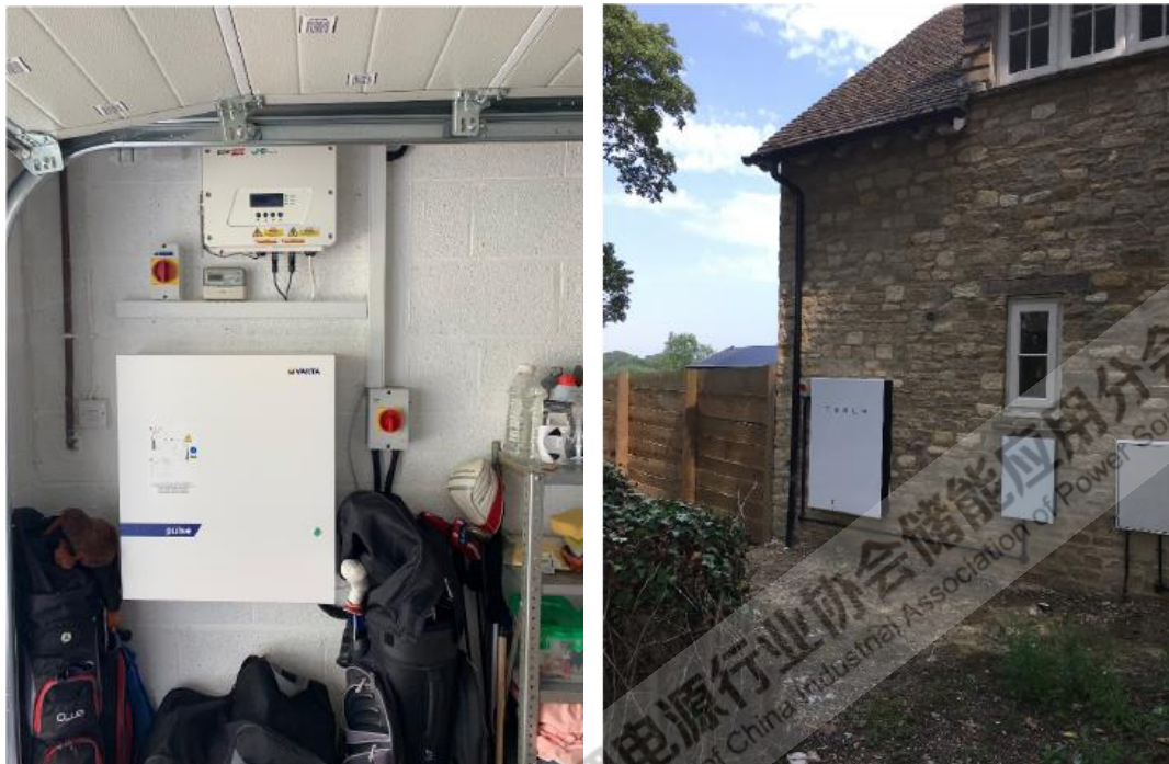
图3 在车库和户外墙壁安装的电池储能系统
